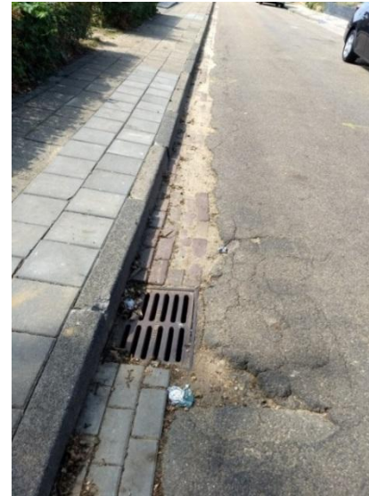
Figuur 17. Schade in (te dunne) deklagen vragen om structurele oplossing (locatie: Burgemeester Murisstraat)
